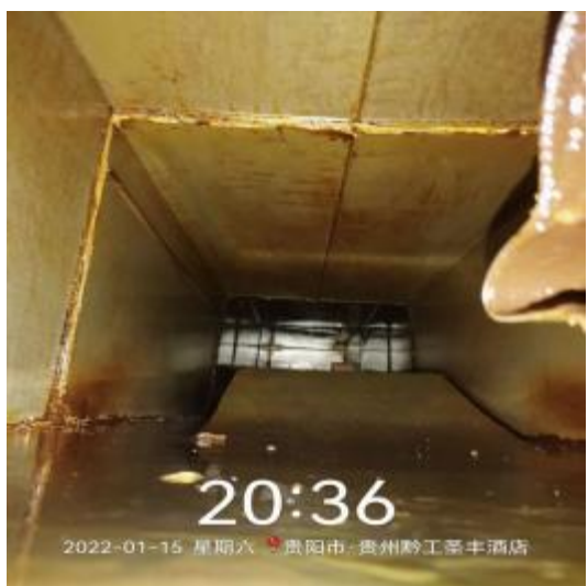
中厨房管道清洗前
