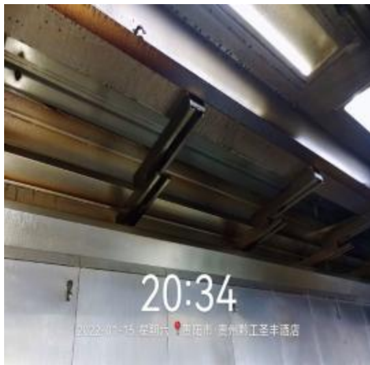
中厨房烟罩清洗前
