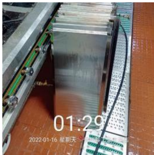
中厨房防火板清洗后
