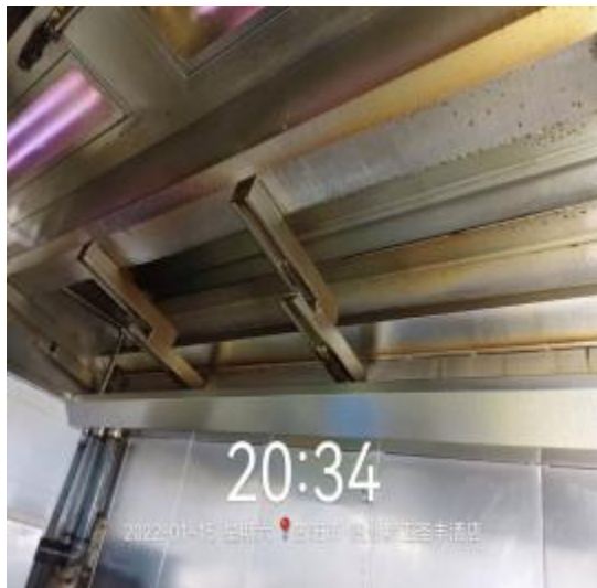
中厨房烟罩清洗前
