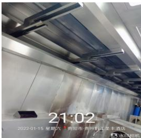
北楼厨房烟罩清洗前
