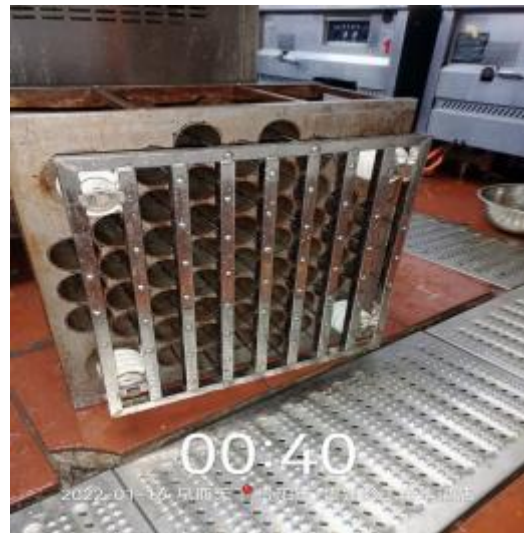
净化器施工后
