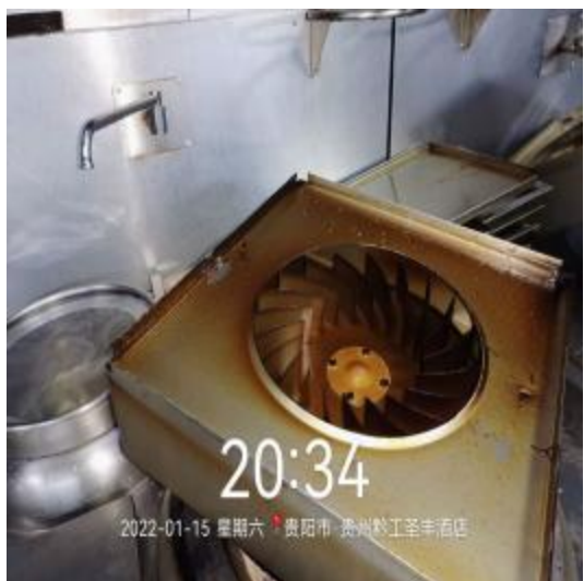
运水风扇清洗前
