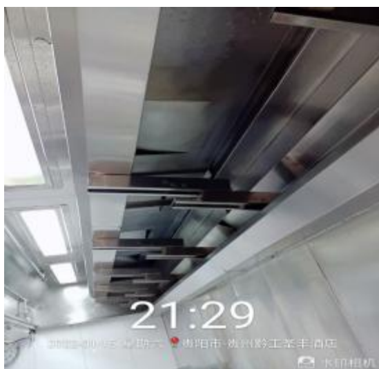
北楼厨房烟罩清洗前
