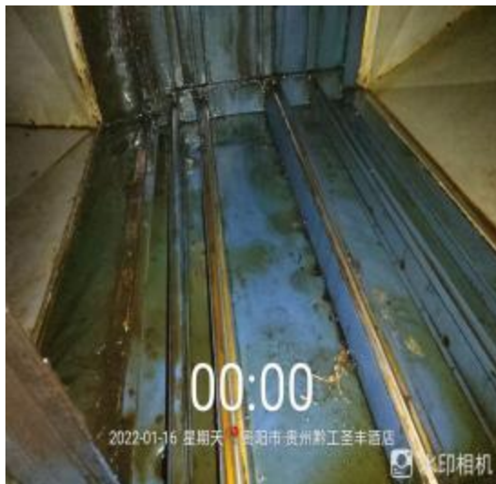
净化器机箱清洗前
