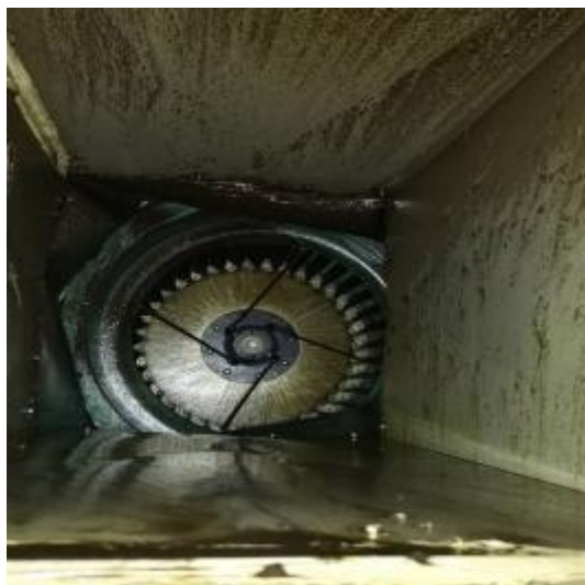
管道风机清洗前
