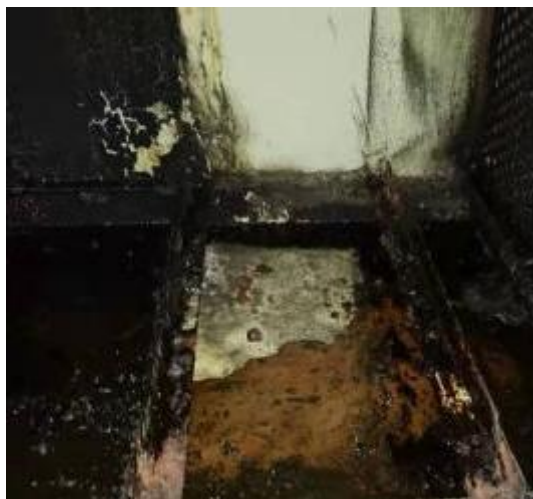
净化器机箱清洗前
