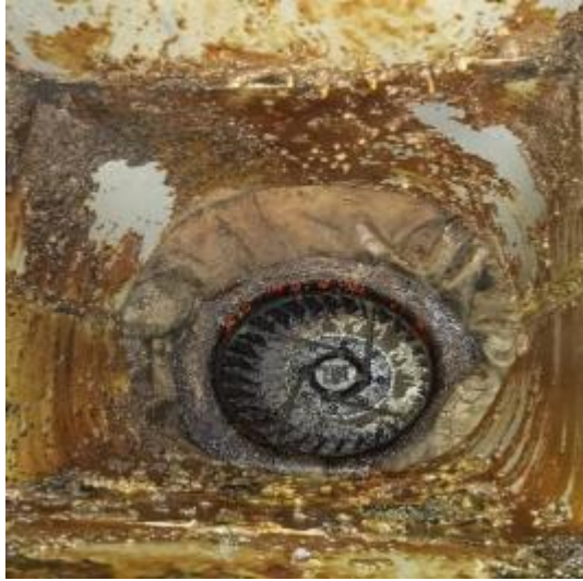
一食堂风机清洗前
