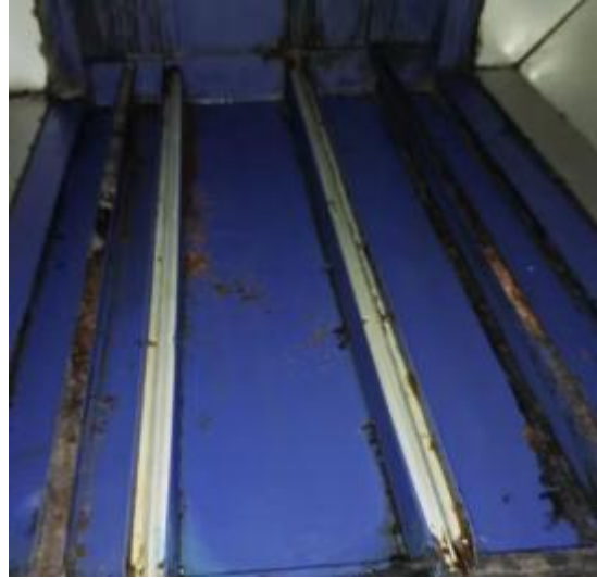
二食堂净化器机箱清洗后
