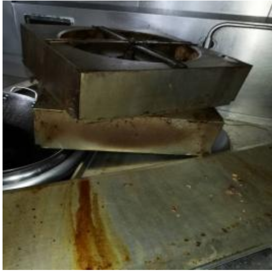
一食堂防火板清洗前
