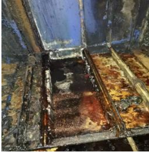
二食堂净化器机箱清洗前
