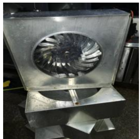
一食堂运水风扇清洗后
