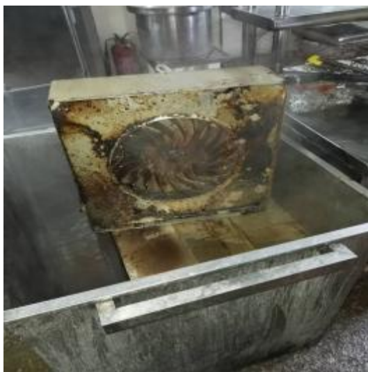
一食堂运水风扇清洗前
