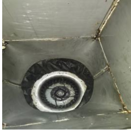
一食堂风机清洗后
