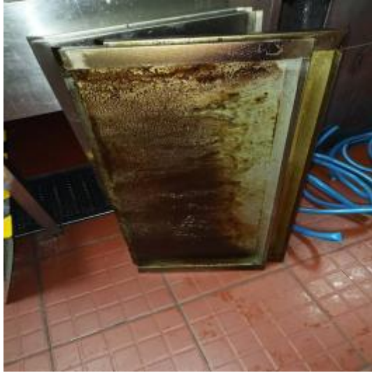
防火板清洗前
