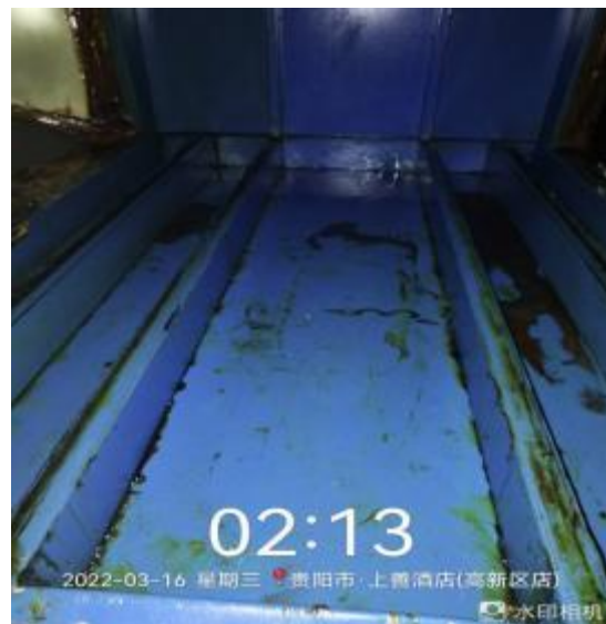
净化器机箱清洗后
