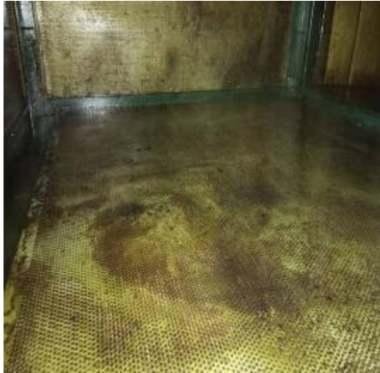
风机机箱清洗前
