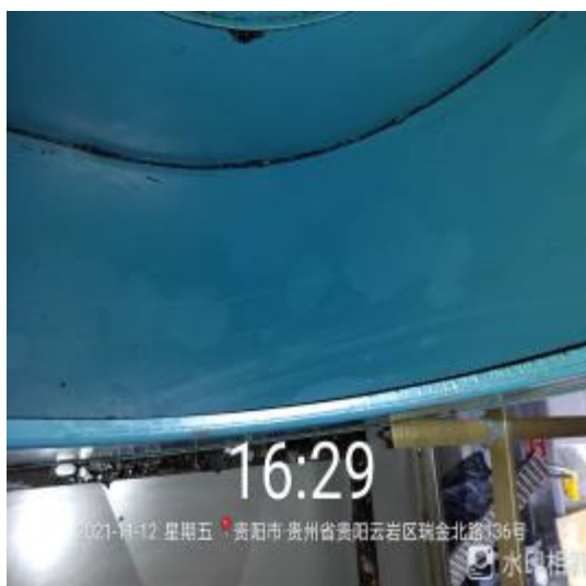
风机机箱清洗后
