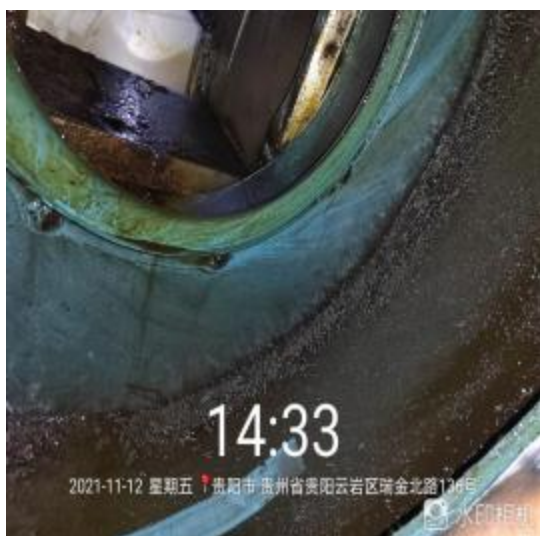
风机机箱清洗前
