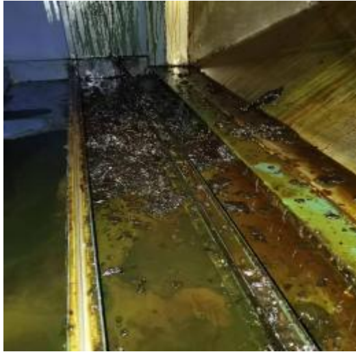
净化器机箱清洗前
