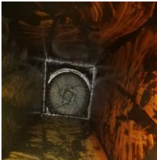
风机管道清洗前
