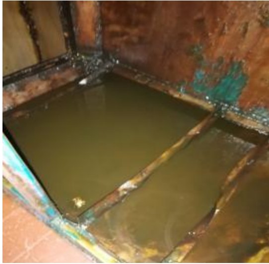
净化器机箱清洗前
