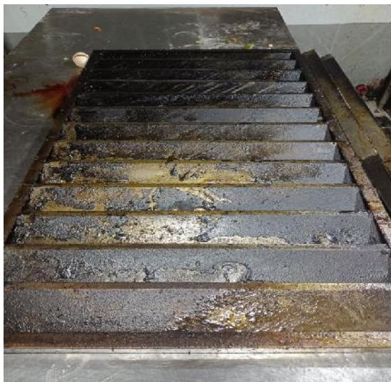
防火板清洗前
