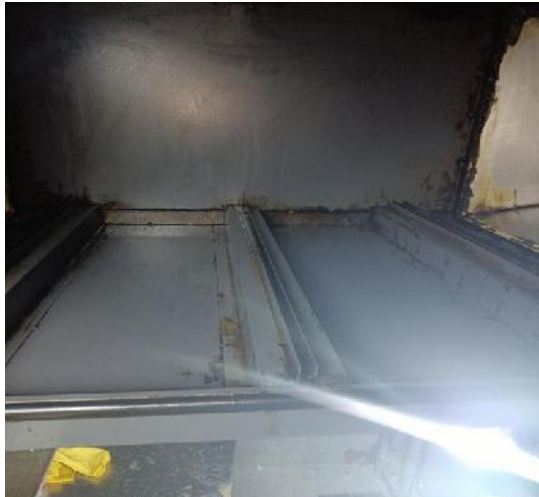
净化器机箱清洗后
