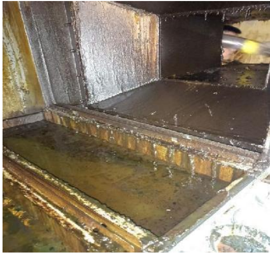
净化器机箱清洗前
