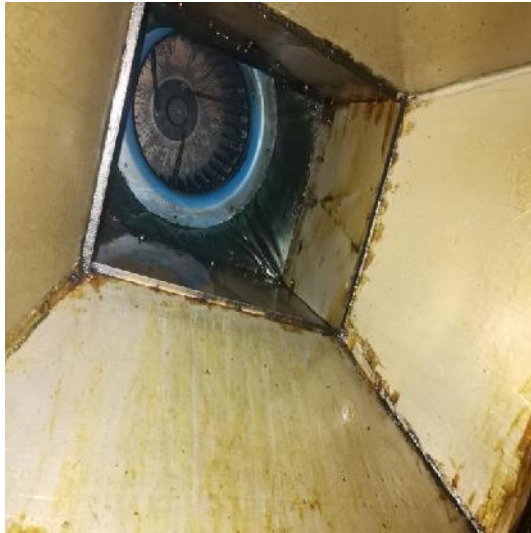
风机管道清洗前
