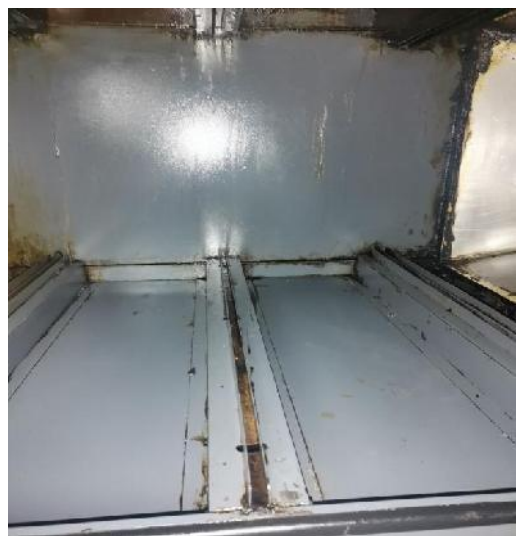
净化器机箱清洗后
