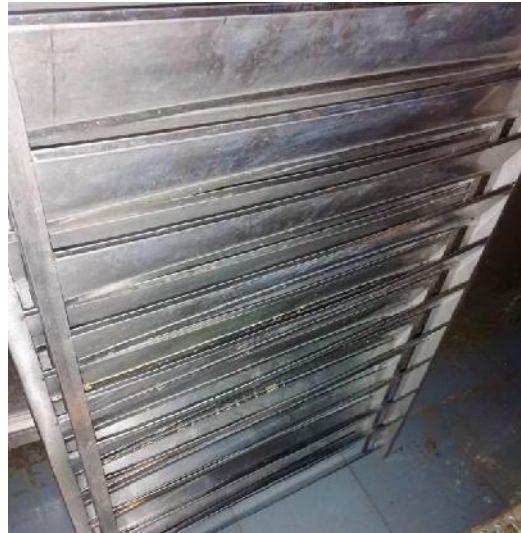
防火板清洗后
