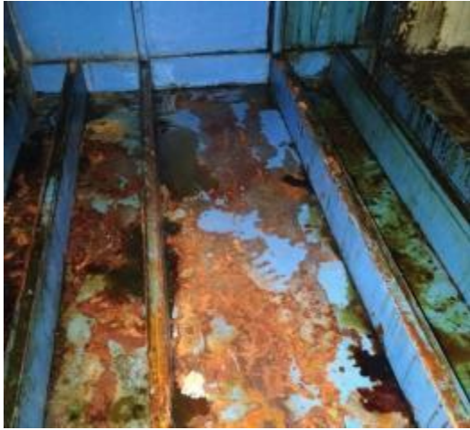
净化器机箱清洗前
