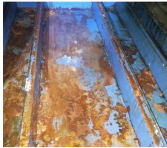
净化器机箱清洗后
