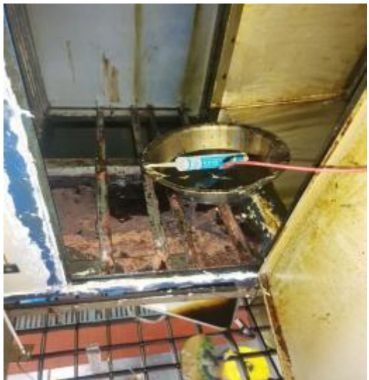
净化器机箱清洗前
