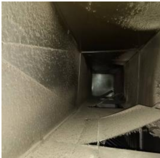
西厨房管道清洗前 2
