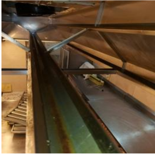
西厨房烟罩清洗前
