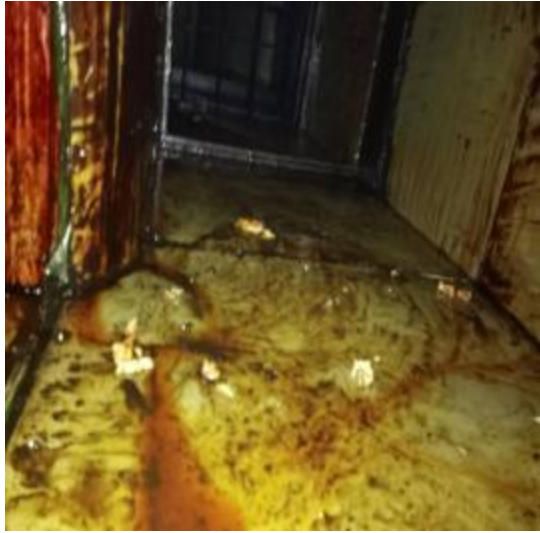
西厨房管道清洗前 1
