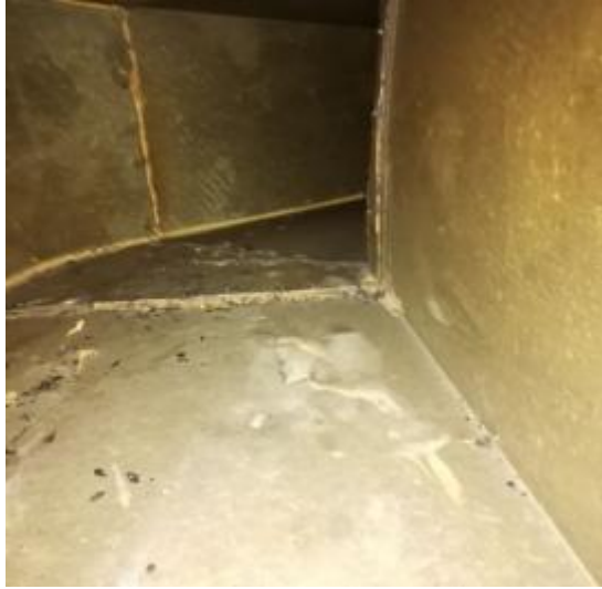
西厨房管道清洗前 3
