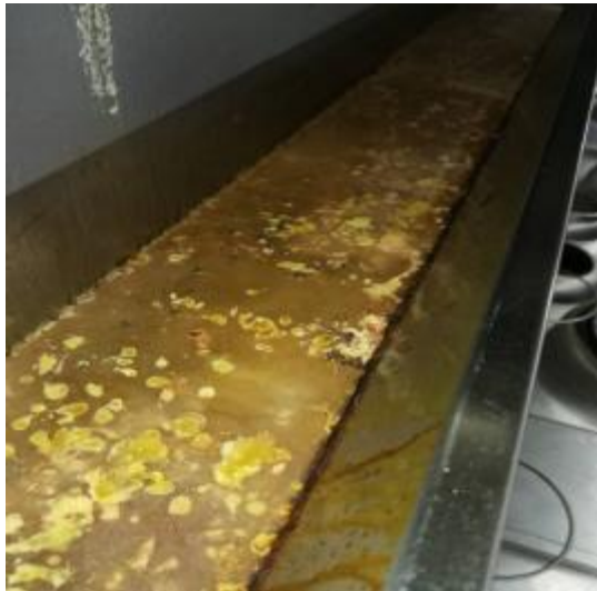
中厨房烟罩油槽清洗前 2
