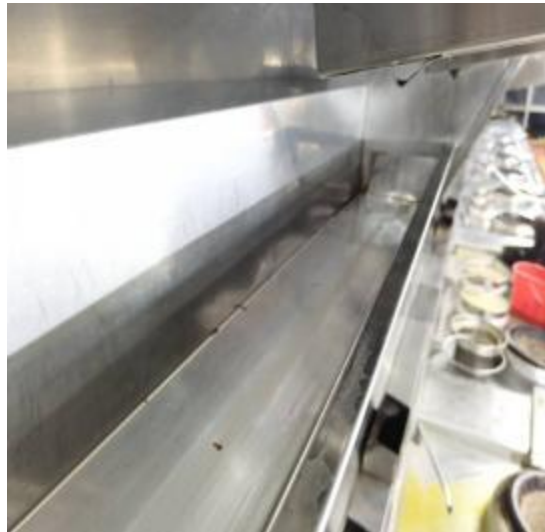
中厨房烟罩油槽清洗后 2
