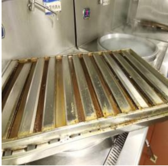
员工厨房防火板清洗前
