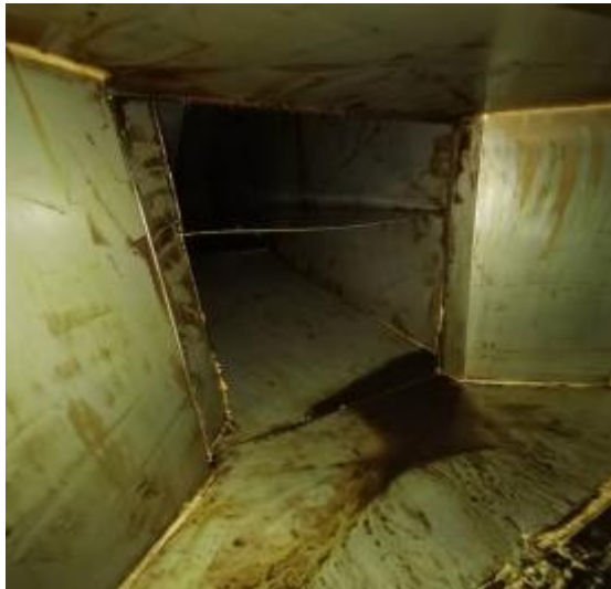
中厨房管道清洗前 2
