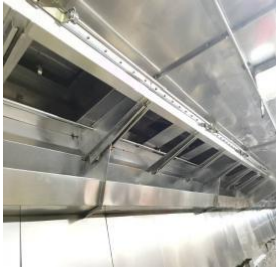
中厨房整体烟罩清洗后
