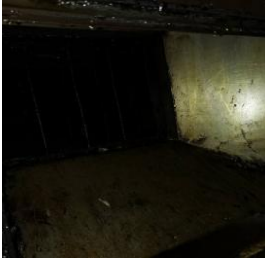
员工厨房管道清洗前 3
