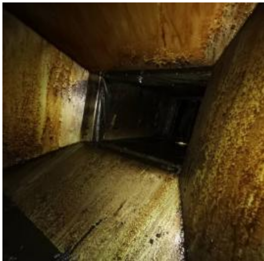
员工厨房管道清洗前 2
