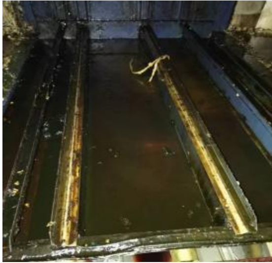
净化器机箱清洗前
