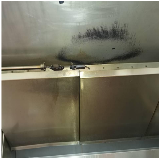
中厨房烟罩清洗前 1
