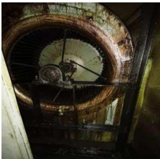
中厨房风机清洗前
