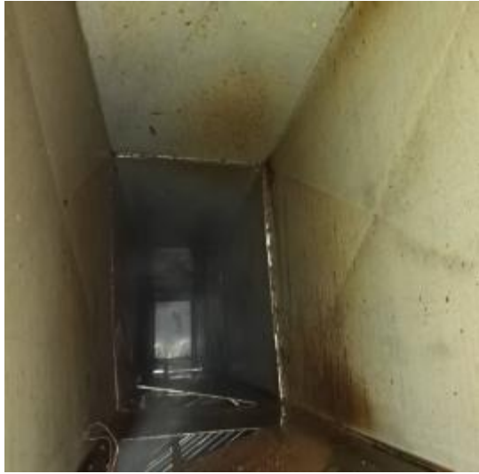
员工厨房管道清洗前 1
