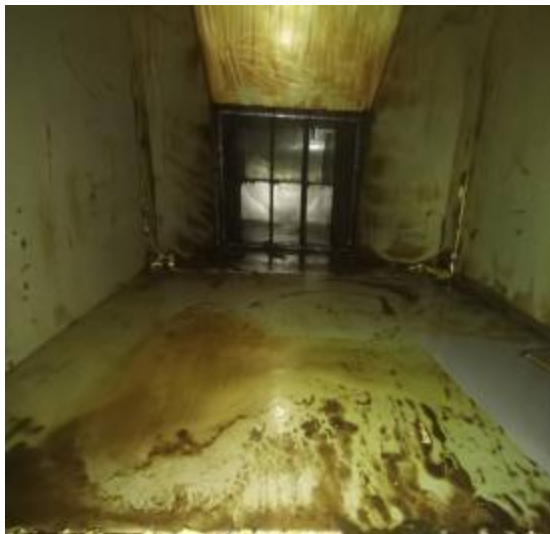
中厨房管道清洗前 1
