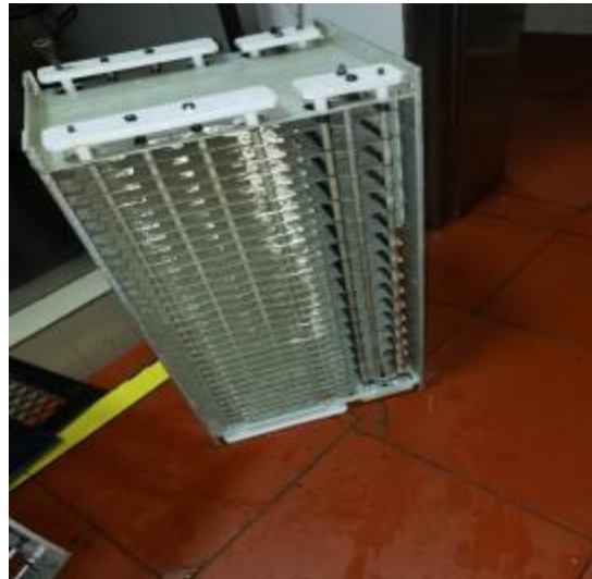
西厨房净化器清洗后
