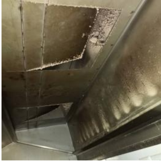
西厨房烟罩清洗前
