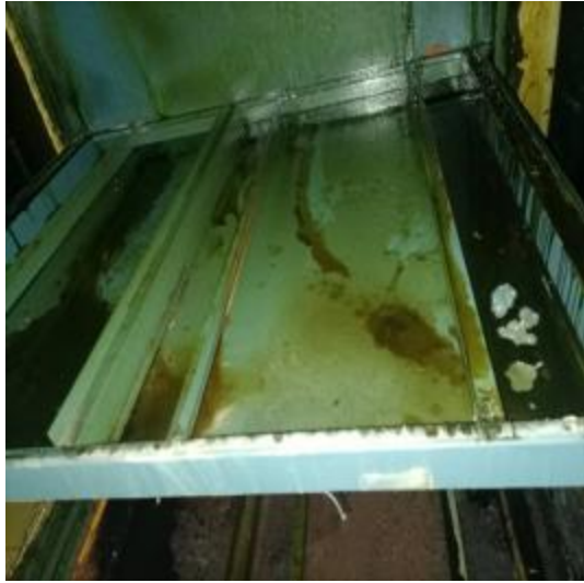
净化器机箱清洗前
