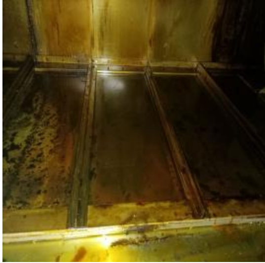
净化器机箱清洗前 2
