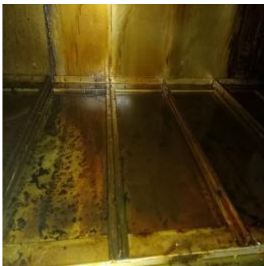
净化器机箱清洗前 1
