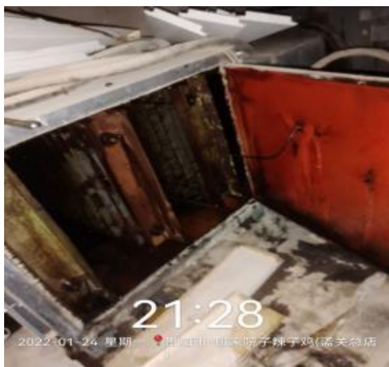
净化器机箱清洗前
