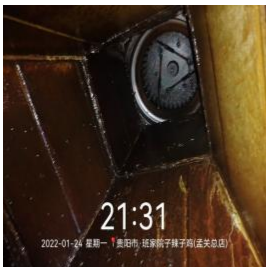
管道风机清洗前
