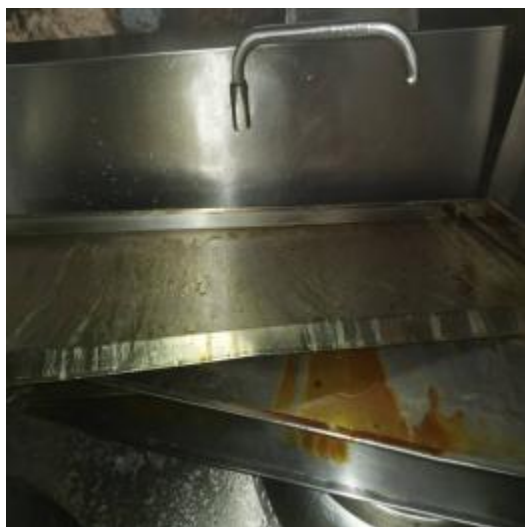
防火板清洗前
