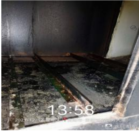
净化器机箱清洗前
