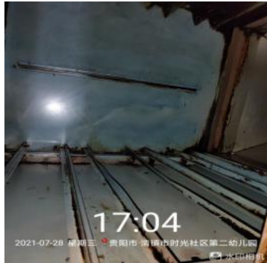
净化器机箱清洗后
