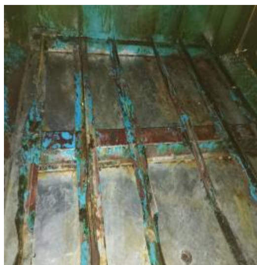
净化器机箱清洗后
