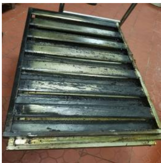
防火板清洗前
