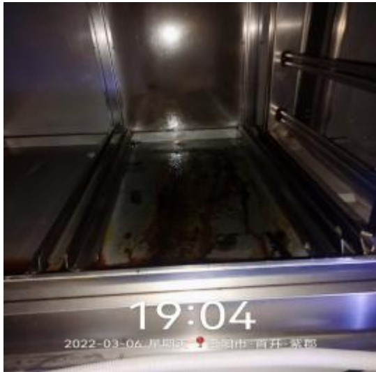
净化器机箱清洗前
