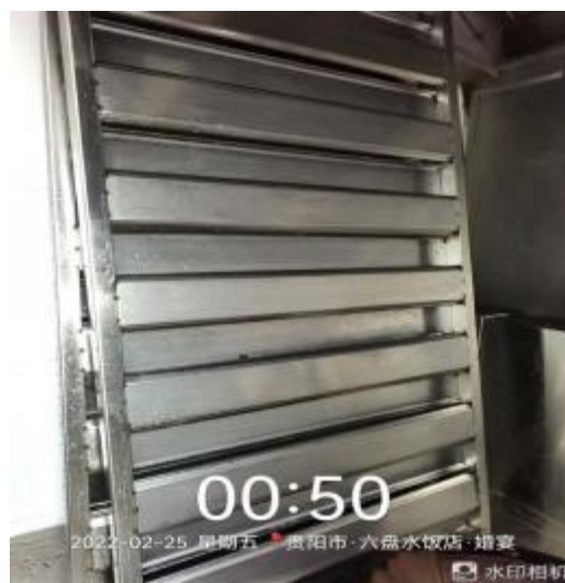
防火板清洗后
