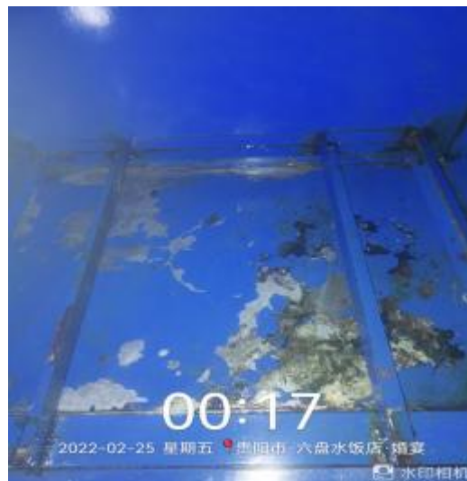
净化器机箱清洗后
