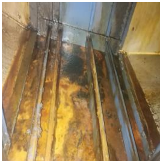
净化器机箱清洗前
