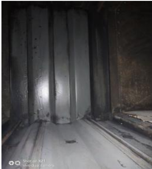
净化器机箱清洗后
