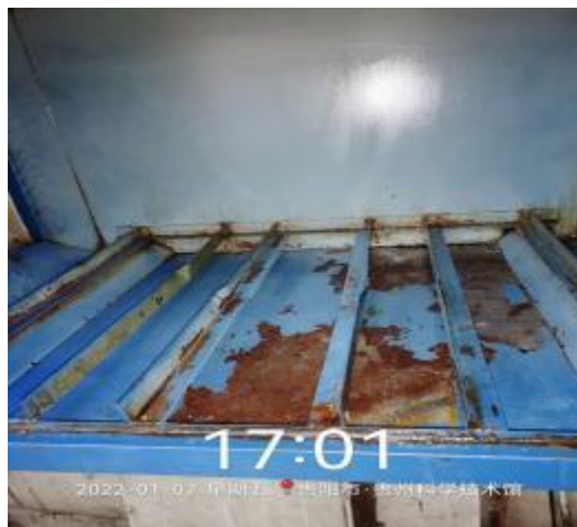
净化器机箱清洗后
