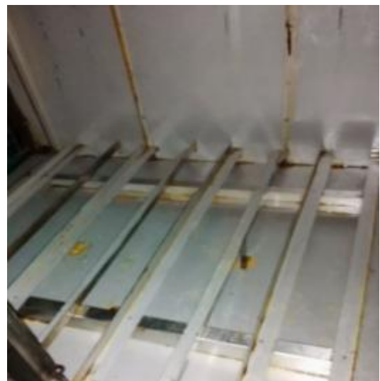
净化器机箱清洗后
