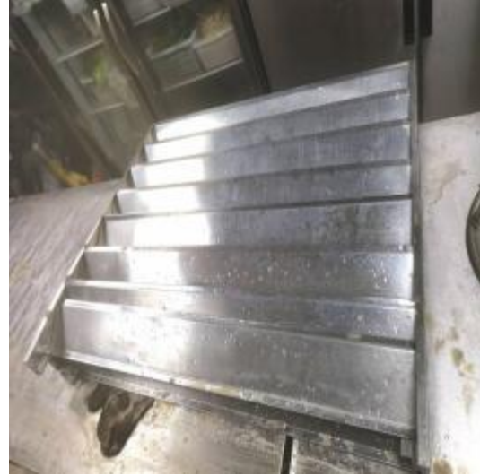
防火板清洗后
