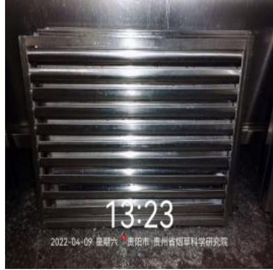
防火板清洗后
