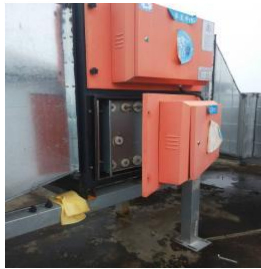
净化器机箱清洗后
