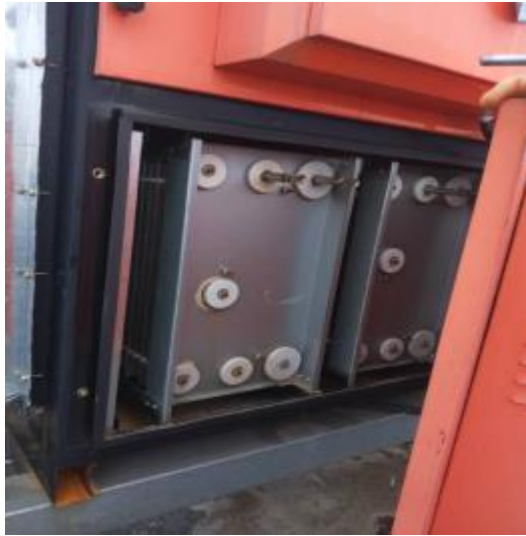
净化器机箱清洗后
