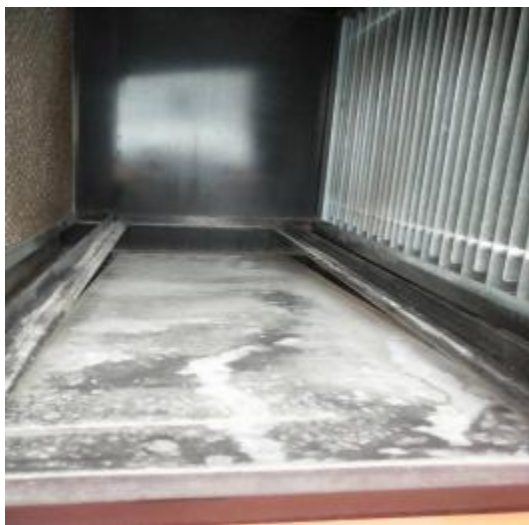
净化器机箱清洗前
