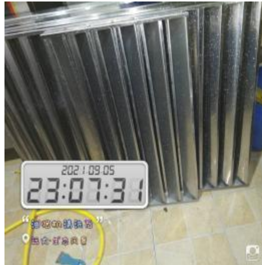
防火板清洗后
