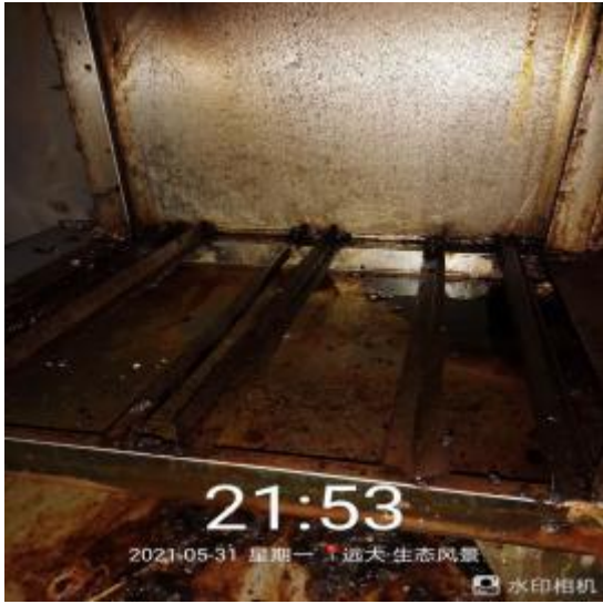
净化器机箱清洗前
