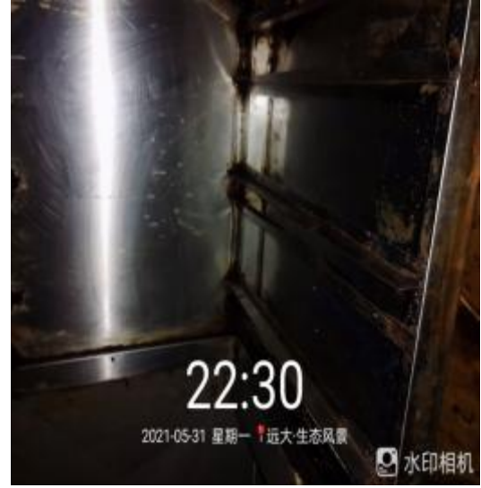
净化器机箱清洗后
