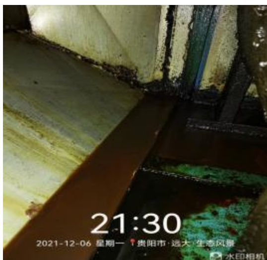
净化器机箱清洗前
