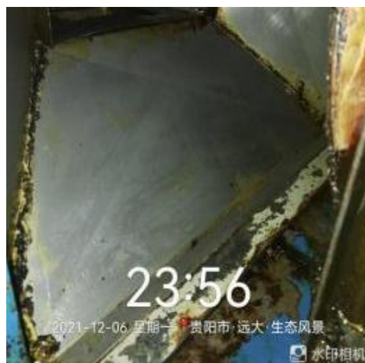
净化器机箱清洗后
