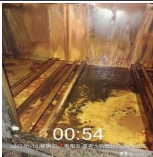
净化器机箱清洗前
