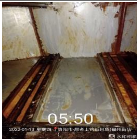
净化器机箱清洗后
