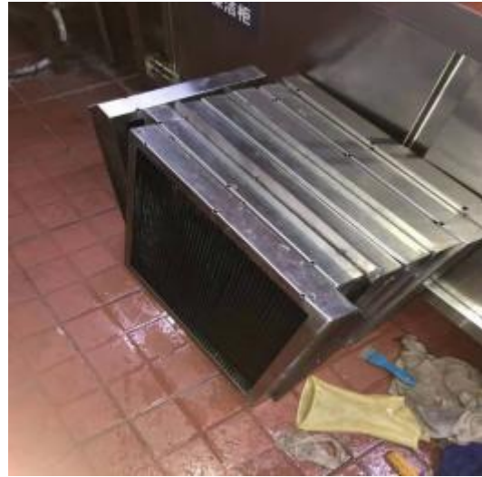
防火板清洗后
