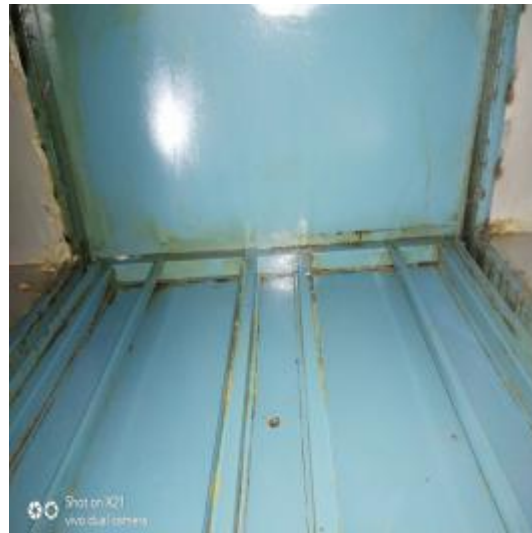
净化器机箱清洗后
