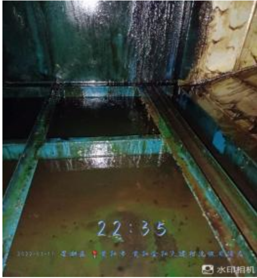
净化器机箱清洗前
