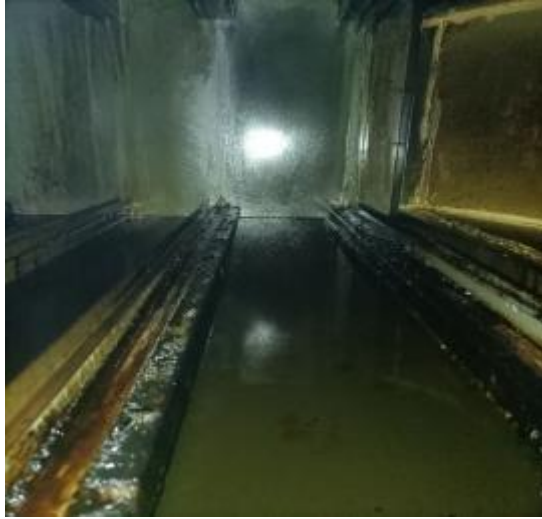
净化器机箱清洗前
