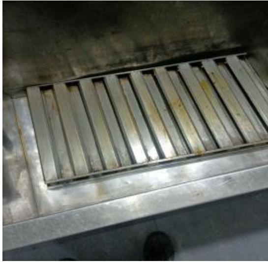
防火板清洗前
