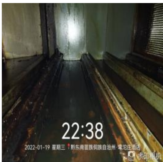
净化器机箱清洗前
