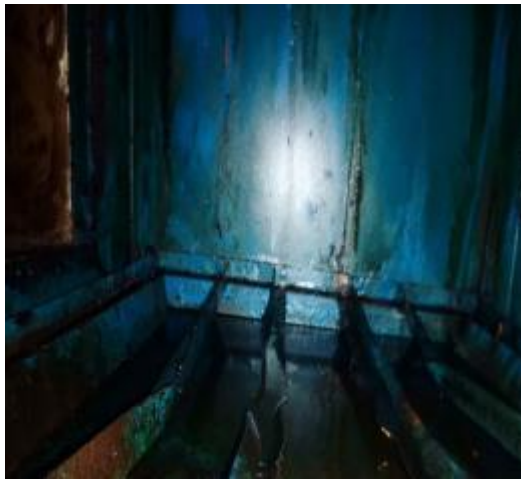
净化器机箱清洗前
