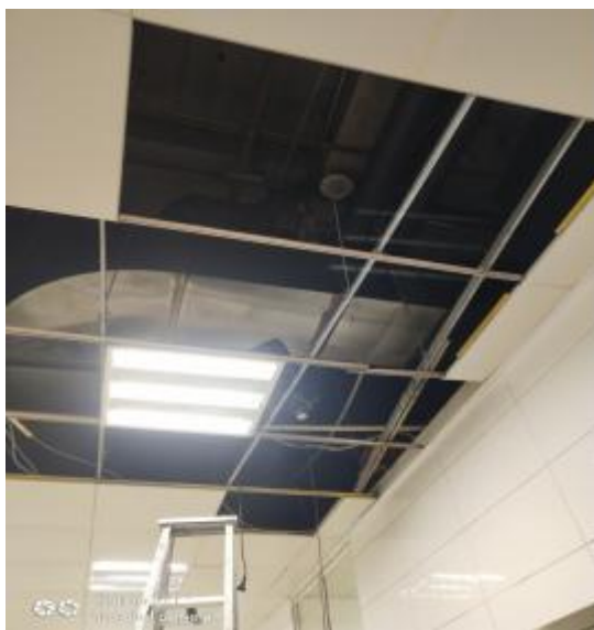
天花板清洗前
