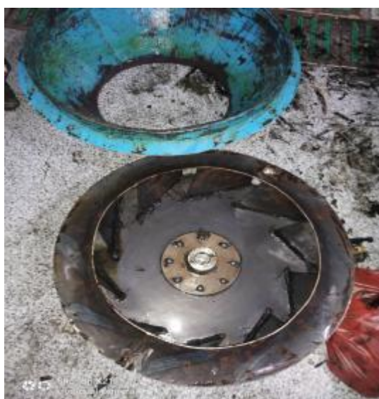
风机拆后清洗后 1
