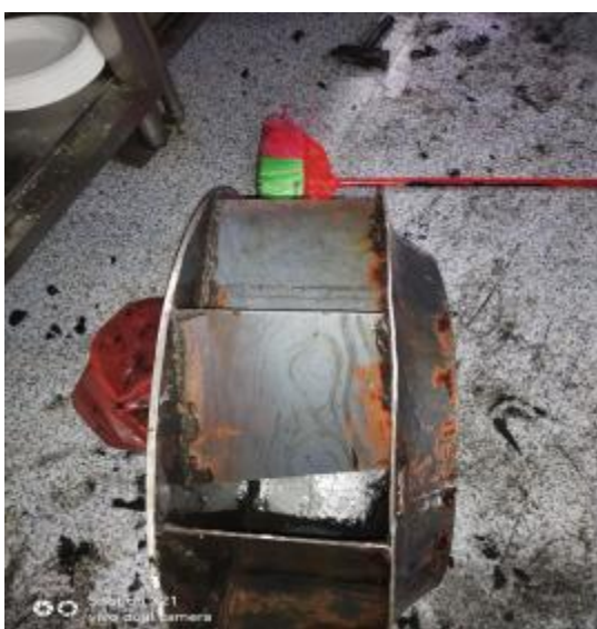
风机拆后清洗后 2
