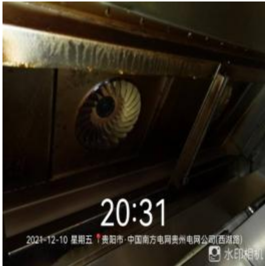
运水风扇清洗前
