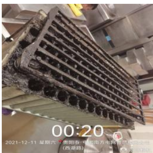
净化器机箱清洗前
