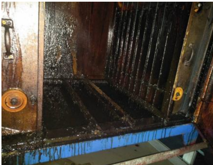
净化器内部清洗前
