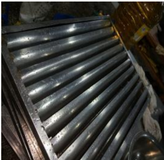
防火板清洗后
