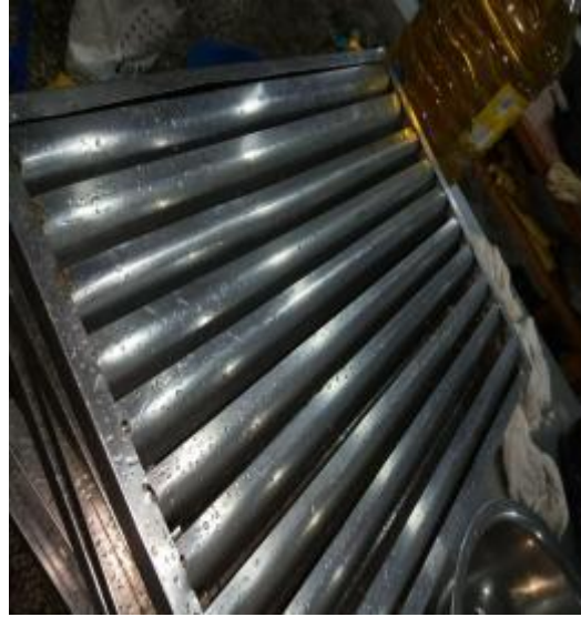
防火板清洗后
