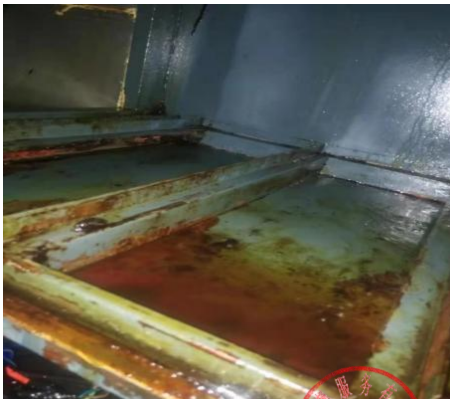
净化器机箱清洗前
