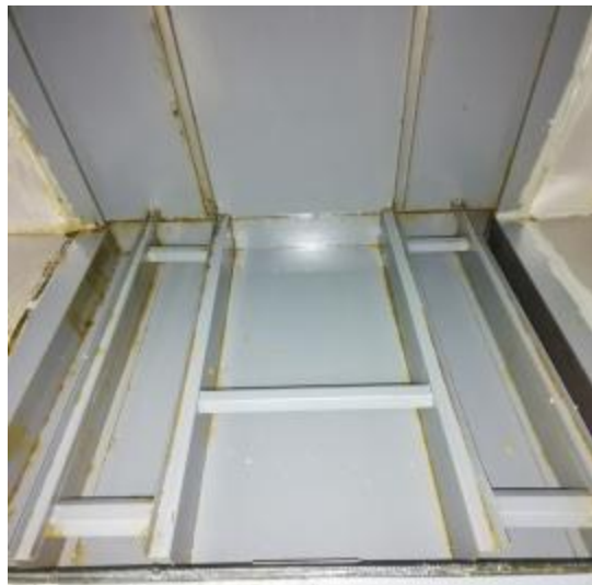
净化器机箱清洗后
