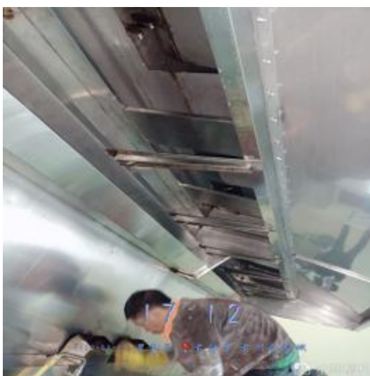
烟罩管道外观清洗后
