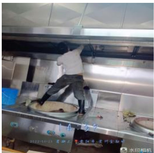
烟罩管道外观清洗前
