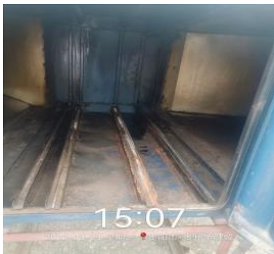
净化器机箱清洗前
