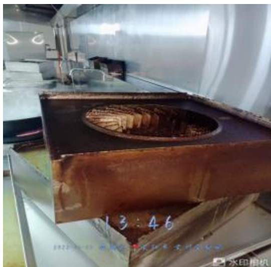
运水风扇清洗前
