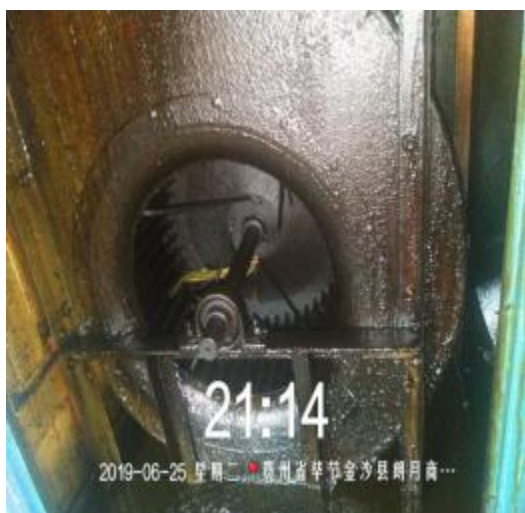
明京大酒楼风机清洗前
