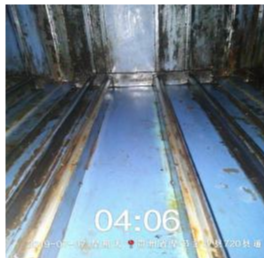
彭厨净化器内部清洗后
