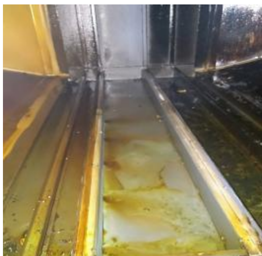
明京大酒楼净化器内部清洗前
