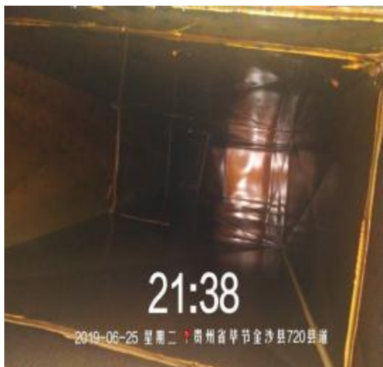
明京大酒楼主管道清洗前 2
