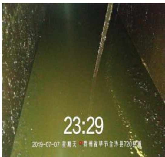
彭厨主管道清洗前 1
