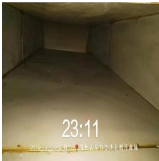
石锅鱼主管道清洗前
