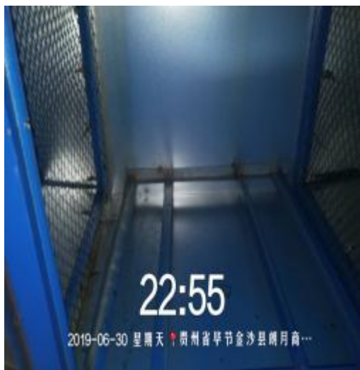
公鸡煲净化器内部清洗前
