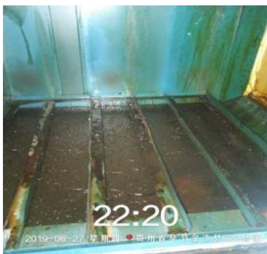
小高山火锅净化器内部清洗前
