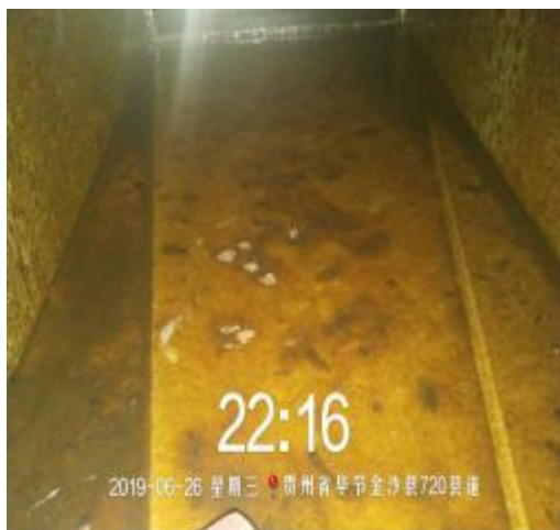
大虎主管道清洗前
