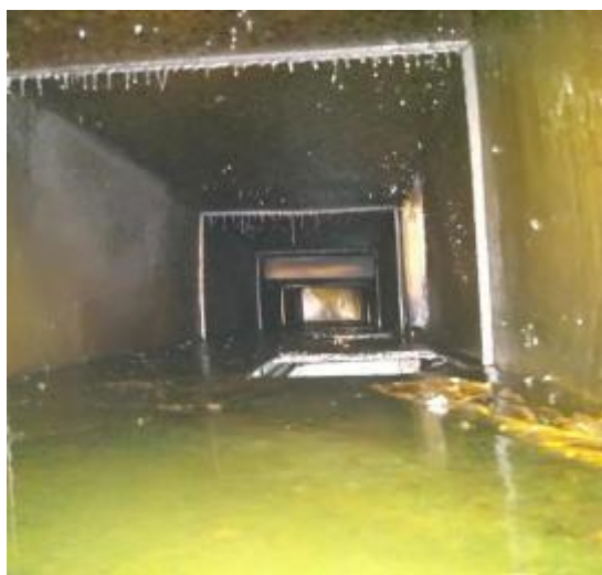
明京大酒楼管道清洗前
