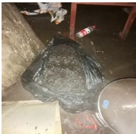
垂直管道铲除油污
